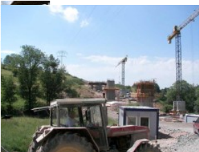
Bild 3: Standort (analog Bild 1) am Körnebachtal - während des Baues (südliches Widerlager der Körnebachtalbrücke) - Juli 2006
